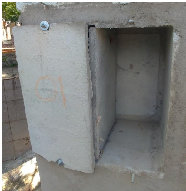
Caixa de concreto com divisória e tampa.
