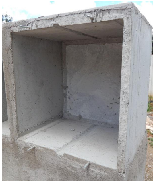
Caixa de concreto sem a divisória.
